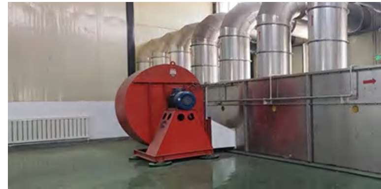
Cold air fan
